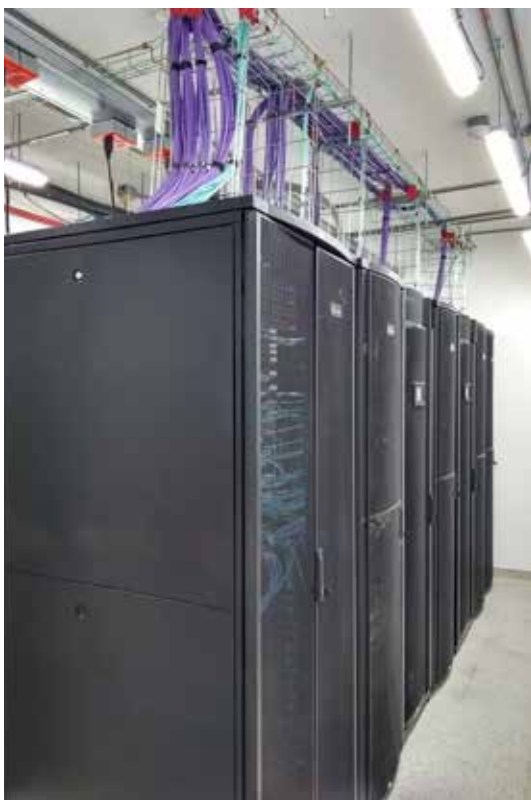
Imagen 42. Estado actual del centro de procesamiento de datos
